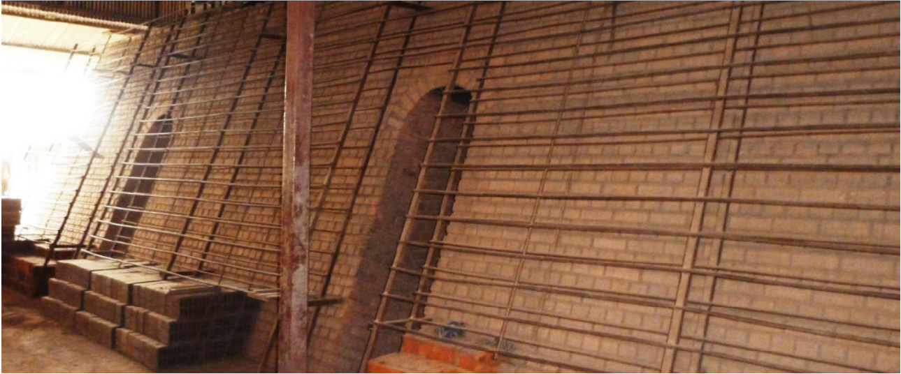
Ancien four ougandais d'Amagerwa (Kigali, Rwanda) avec une capacité de production moyenne de 4 à 4,5 millions de briques par an.
