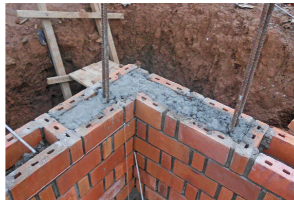
Poutre de liaison d'angle en béton armé
