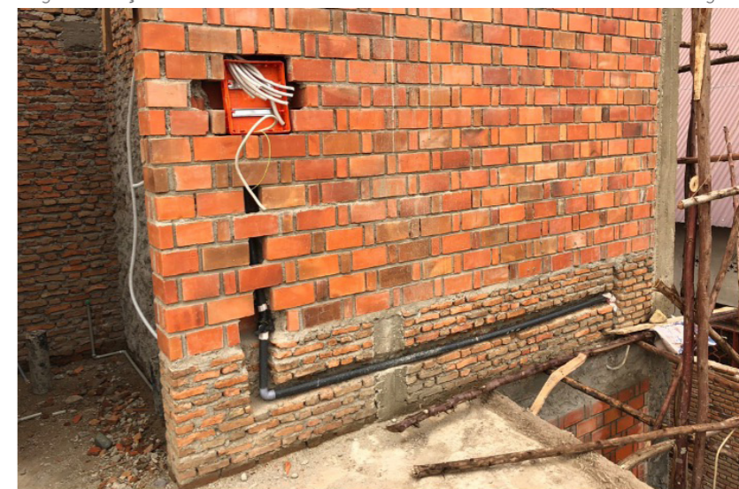
Mélange de maçonneries ordinaires et RLB et des différentes solutions d'intégration MEP
