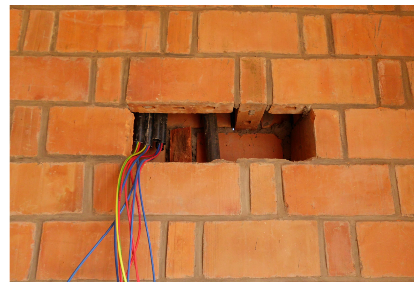
Conduits et câbles électriques acheminés à travers les cavités RLB
