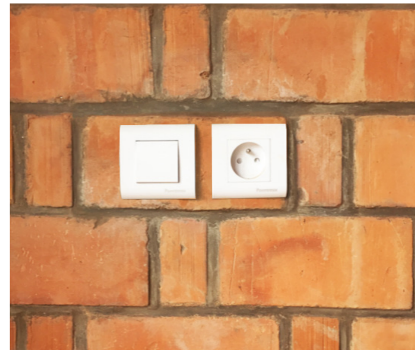
Prises et interrupteurs installés sur un mur en maçonnerie RLB
